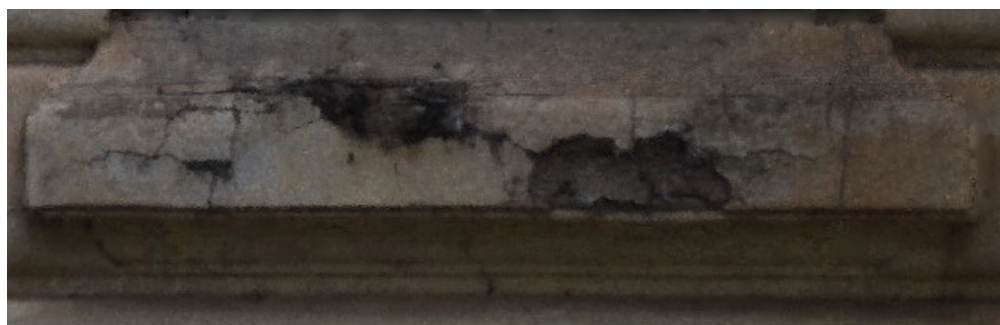
Figura 6. Ortofoto elevación sur. Detalle de patologías.
