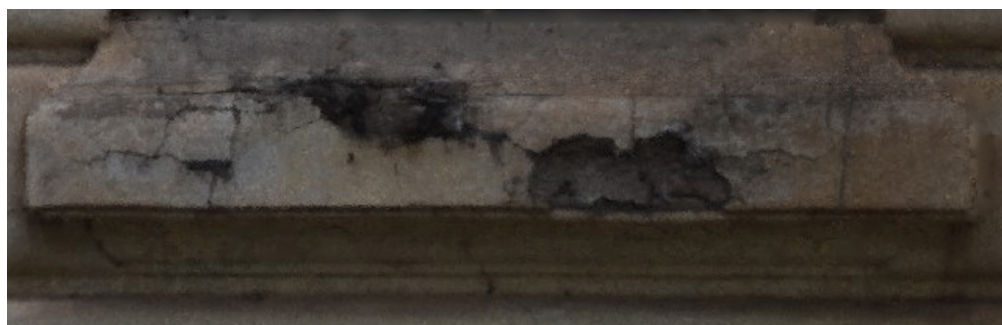
Figura 6. Ortofoto elevación sur. Detalle de patologías.
